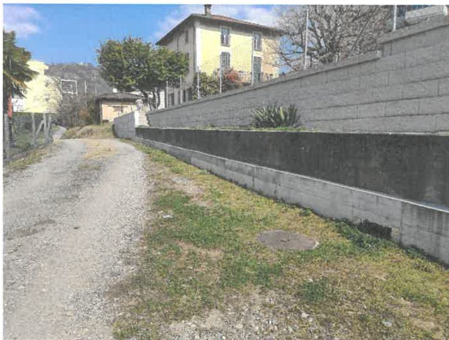
Foto 15 – Pozzetto esistente di arrivo N°69c
